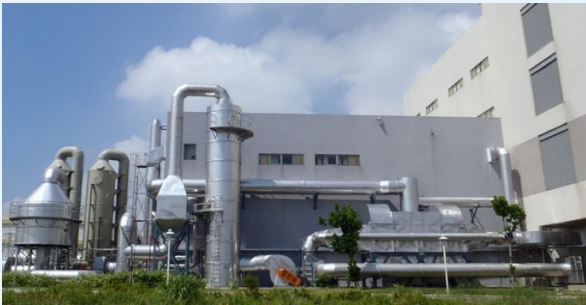
VOCs 冷凝濃縮系統
